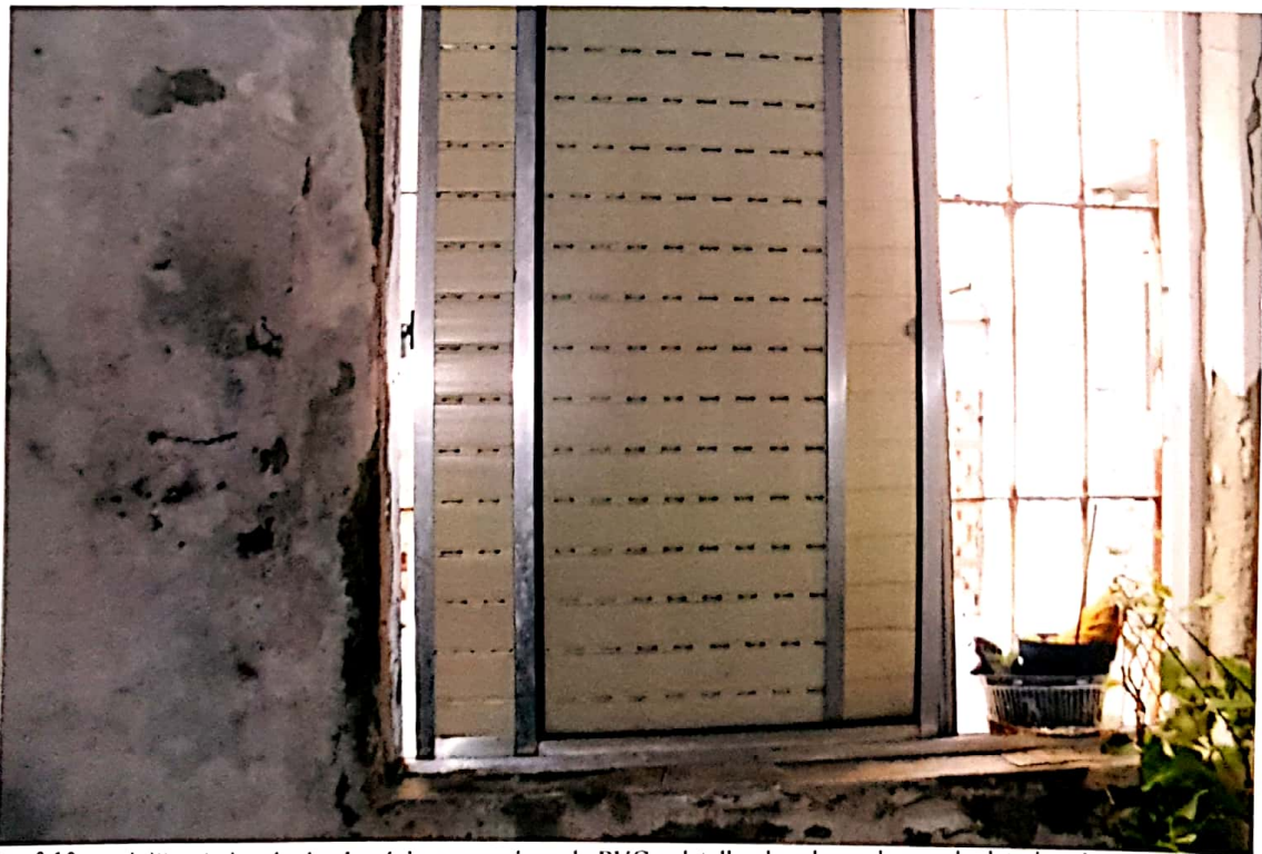
foto nº 10 – caixilho da janela de alumínio e veneziana de PVC e detalhe do reboco da parede deteriorado comprovando mau estado de conservação..
